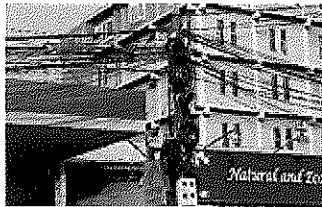
働き者の電柱
